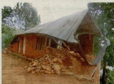
日本からの支援で2001年完成した待望の校舎。地震で全壊状態に
